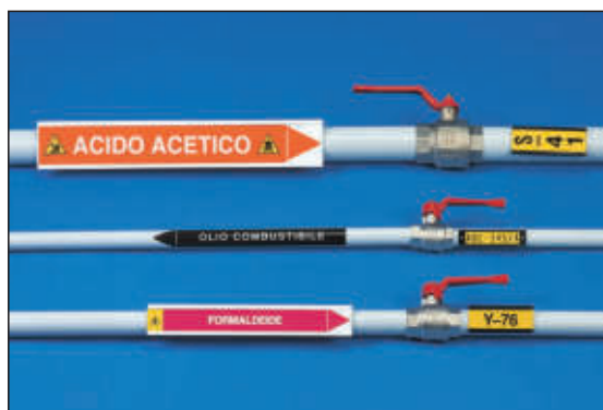
tubazioni con sistema TLS
